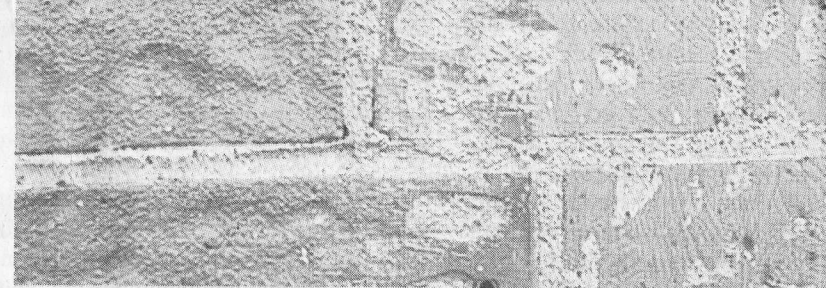
Versuchsweise hat die Stadt probiert, diese abzuschleifen. Fotos: Stadt Ludwigsburg
